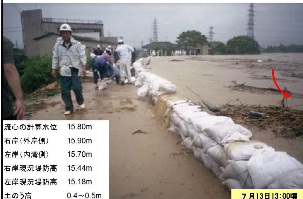
図 2.1.2 群 1/3 越水による破堤の事例 (H16年7月新潟・福島豪雨 五十嵐川)
