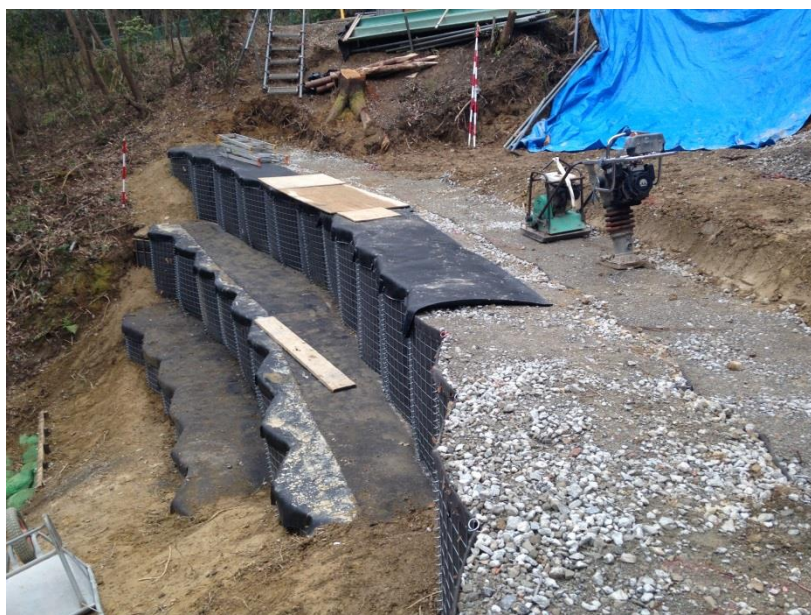
写真-5. 6. 1 中詰め材の流出を防ぐ目的で天端に遮水シートを掛けた事例
