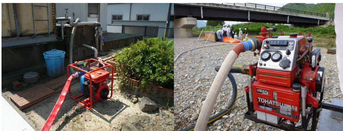
写真 II-6 エンジンポンプ
