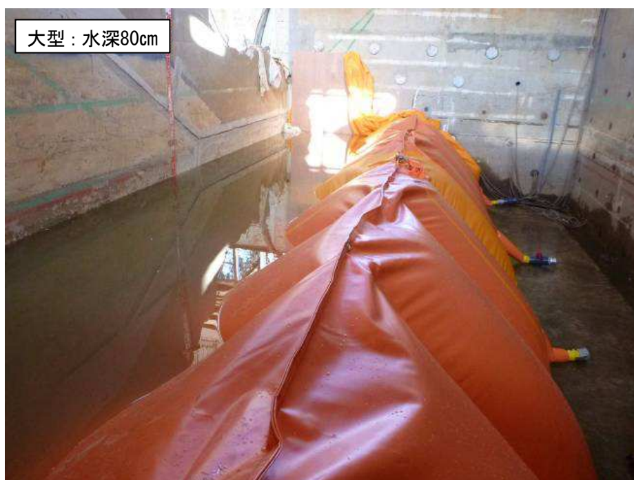
写真 II-19 設計水深時の止水（漏水）状況（大型）
