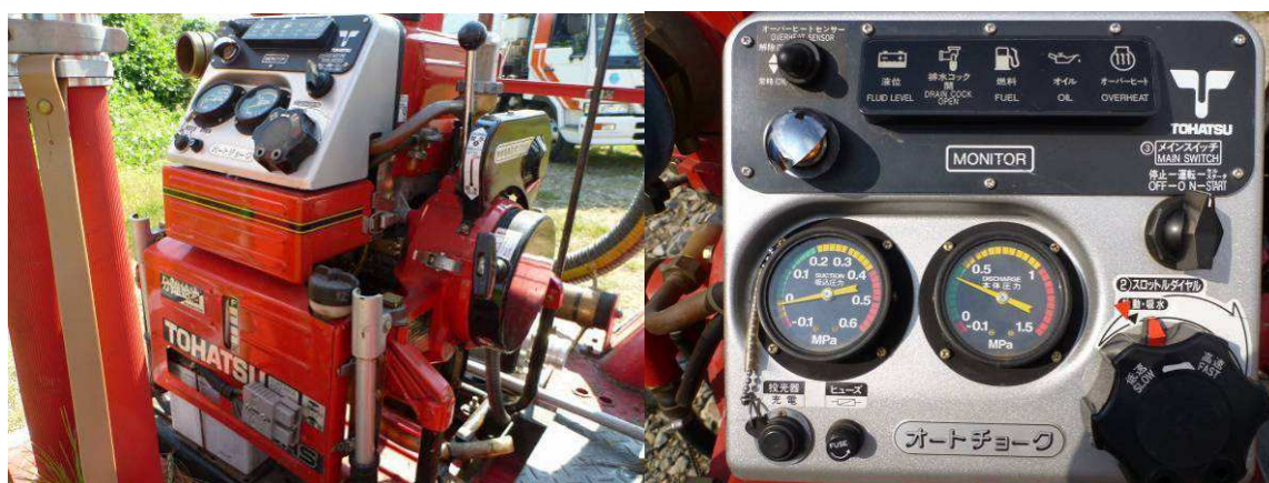
写真 II-29 高圧ポンプ（消防ポンプ）
